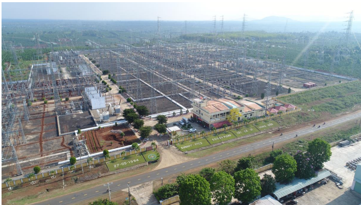
Toàn cảnh Trạm biến áp 500 kV Pleiku
