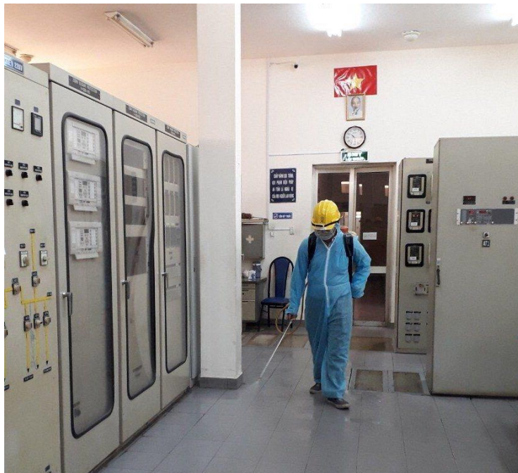
CBCNV trạm 220kV Nhà Bè phun khử khuẩn định kỳ tại khu vực phòng điều hành
