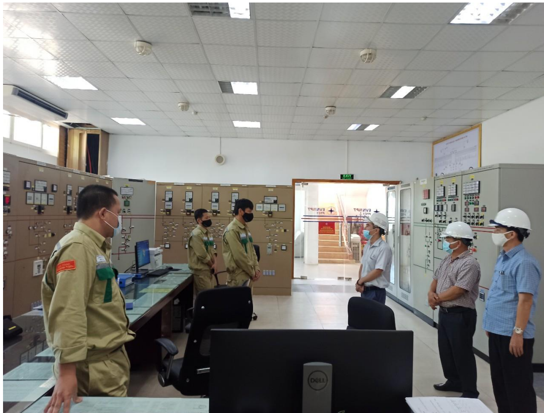
Kiểm tra công tác phòng chống mưa bão tại TBA 500 kV Hà Tĩnh
