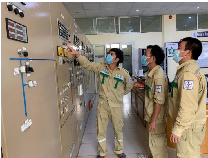
Các điều hành viên trạm 500kV Phú Lâm trao đổi về chức năng các ô đèn mạch sa thải phụ tải đặc biệt đường dây 500kV Bắc - Nam.
