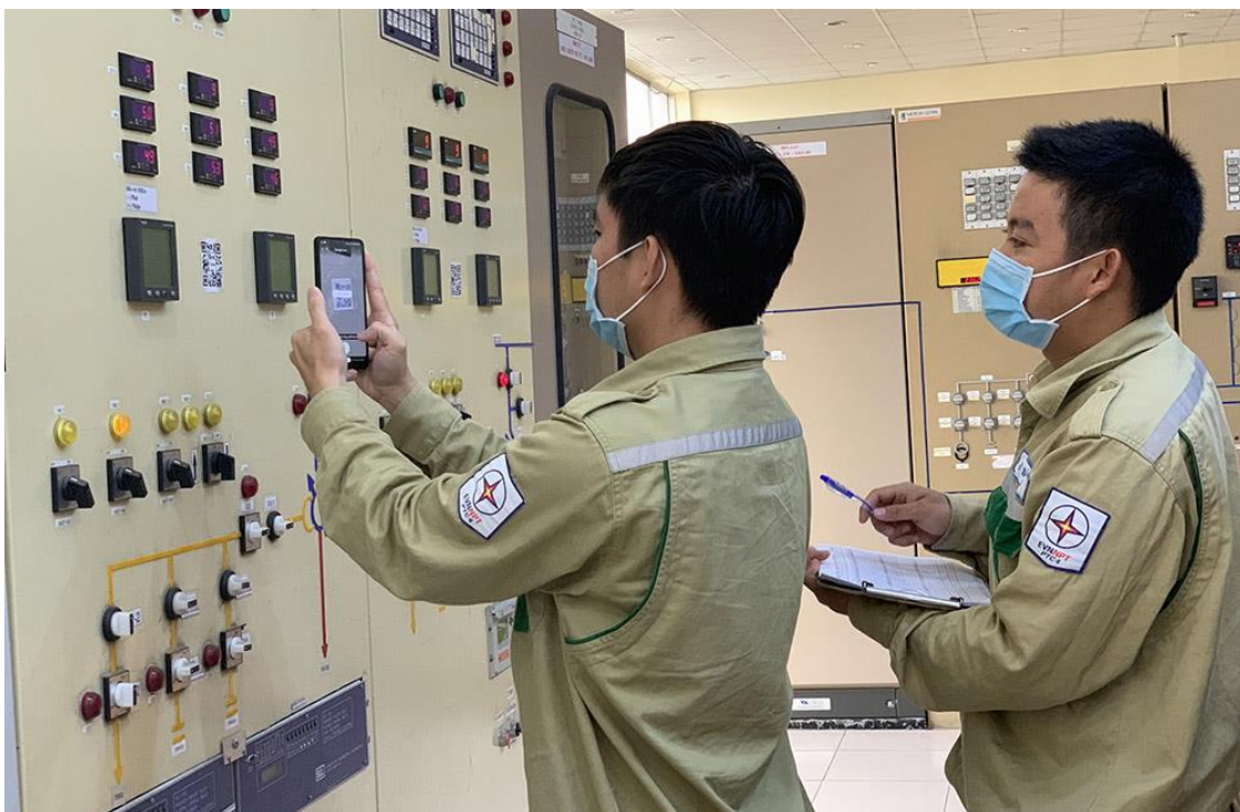
Công nhân TBA quét mã QR-Code cập nhật lý lịch, thông số thiết bị tại Trạm
