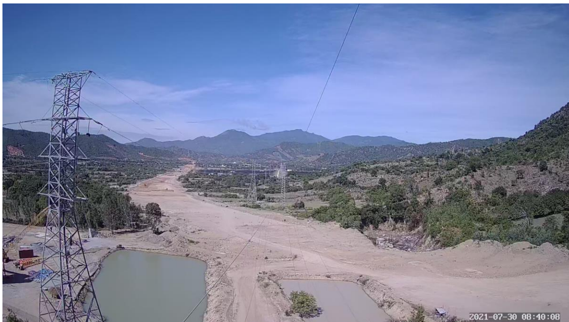
Hình ảnh camera giám sát khoảng cột giao chéo đường cao tốc đoạn Cam Ranh - Nha Trang đang thi công, tại Vị trí 155 đường dây 220kV Thiên Tân - Nha Trang.
