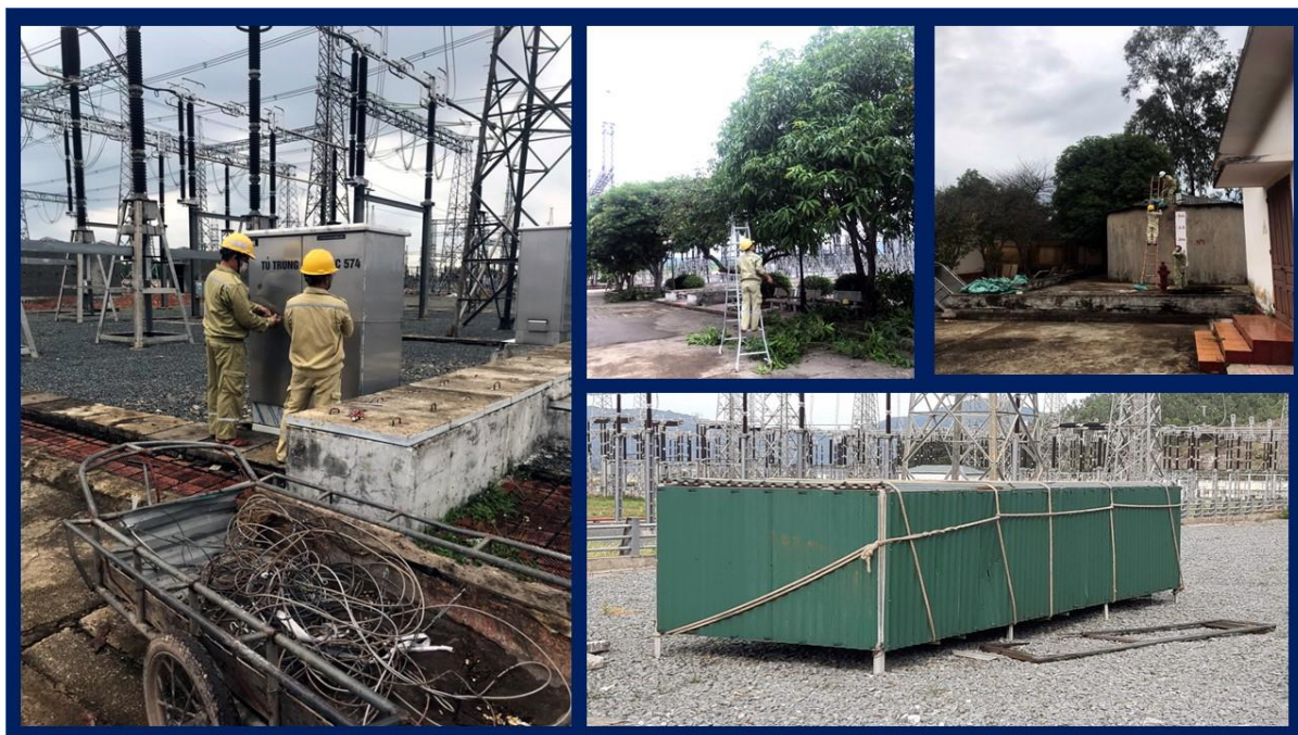
TBA 500 kV Hà Tĩnh chủ động phòng chống bão CONSON
