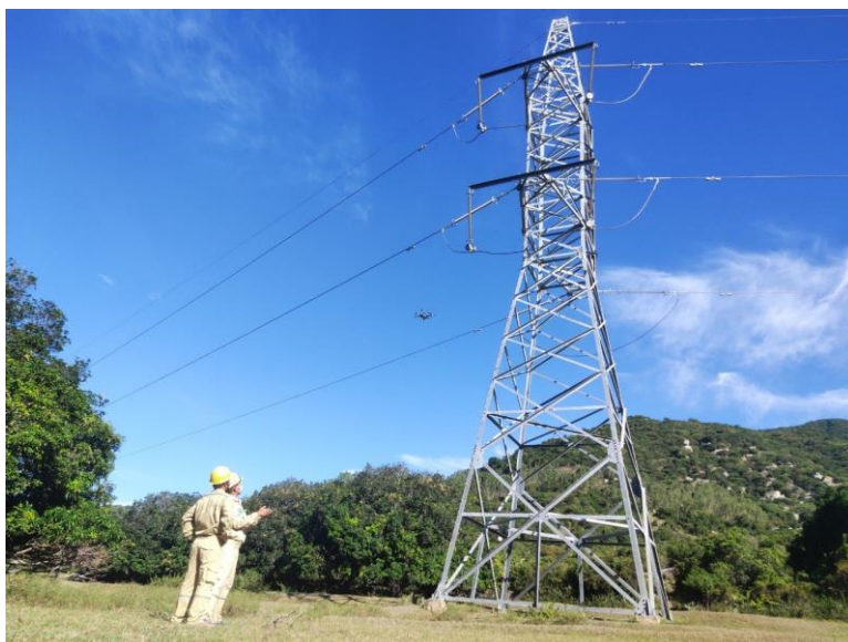
Đội Truyền tải điện Cam Ranh sử dụng Flycam để kiểm tra cách điện và phụ kiện tại vị trí 182 đường dây 220kV Thiên Tân - Nha Trang.
