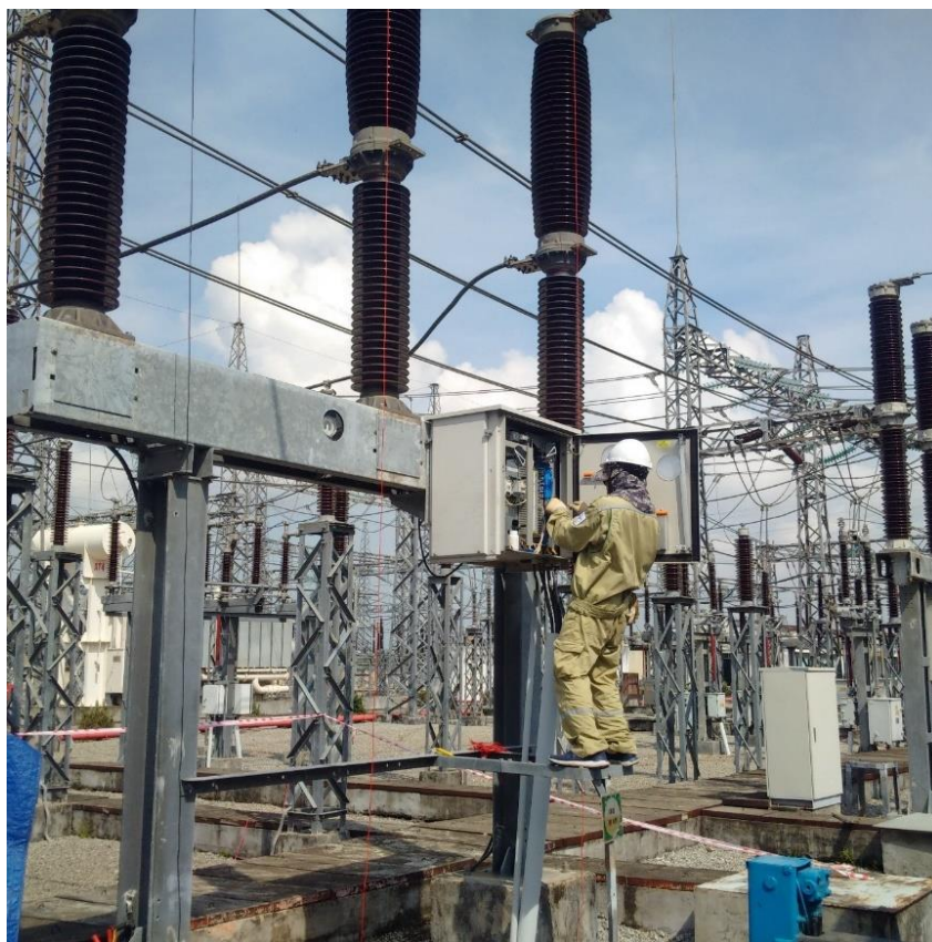
Thí nghiệm máy cắt trạm 500 kV Đà Nẵng
