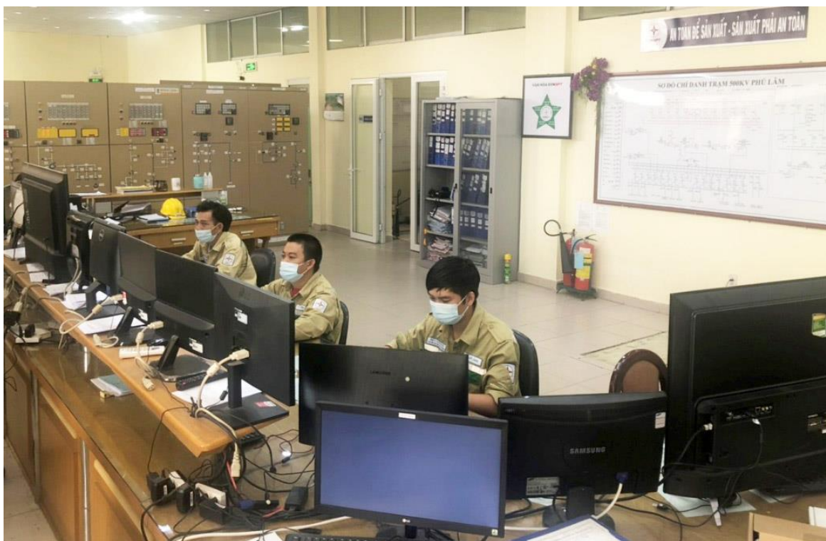
Ca trực vận hành TBA 500 kV Phú Lâm
