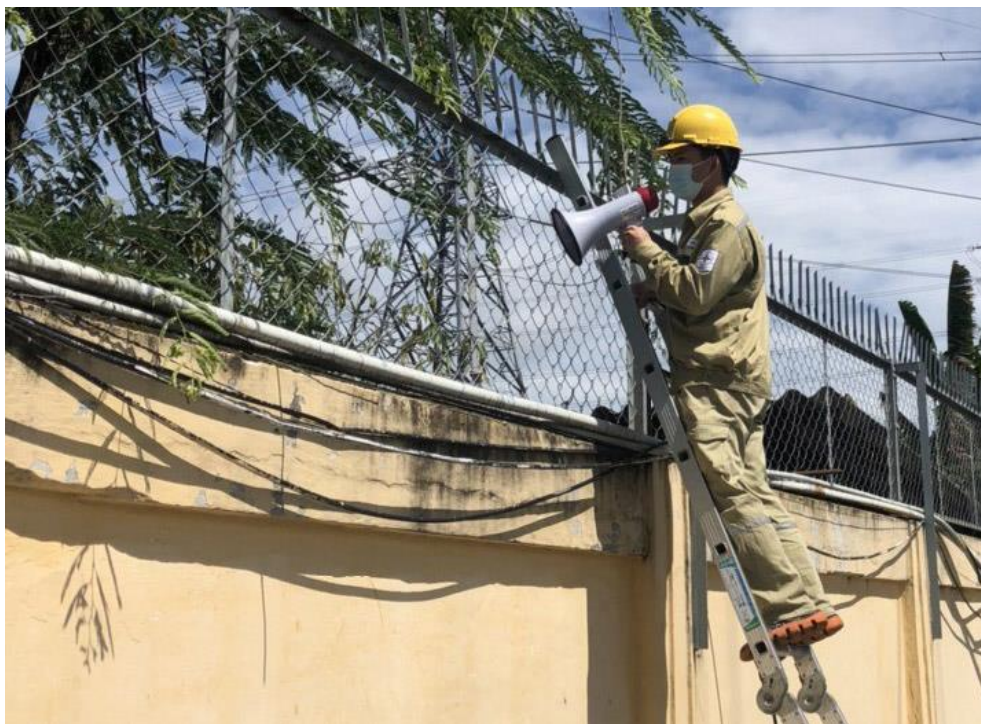
Công nhân TBA 500 kV Phú Lâm dùng loa phóng thanh kêu gọi người dân chặt tỉa cành cây nghiêng vào hàng rào Trạm biến áp trong thời gian giãn cách xã hội
