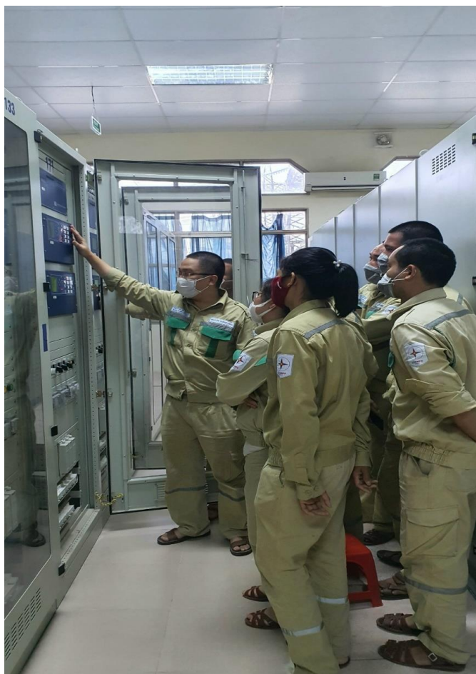
Lực lượng QLVH Trạm 500kV Nho Quan trao đổi, hướng dẫn truy cập Rơ - le, khai thác thông tin trực tiếp tại Rơ - le
