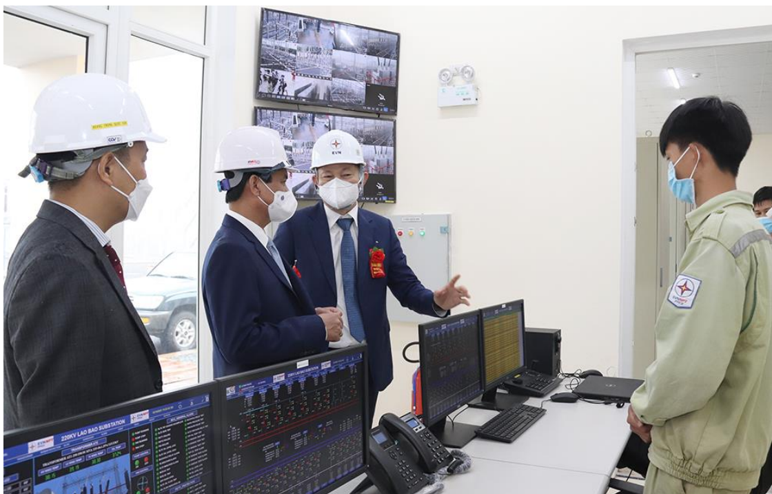
Lãnh đạo UBND tỉnh Quảng Trị, lãnh đạo EVN/EVNNPT thăm phòng vận hành TBA 220 kV Lao Bảo
