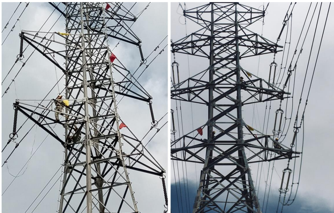
Thực hiện thao tác thử đèn, tiếp địa ngắn mạch trước khi vệ sinh, bảo dưỡng thiết bị.
