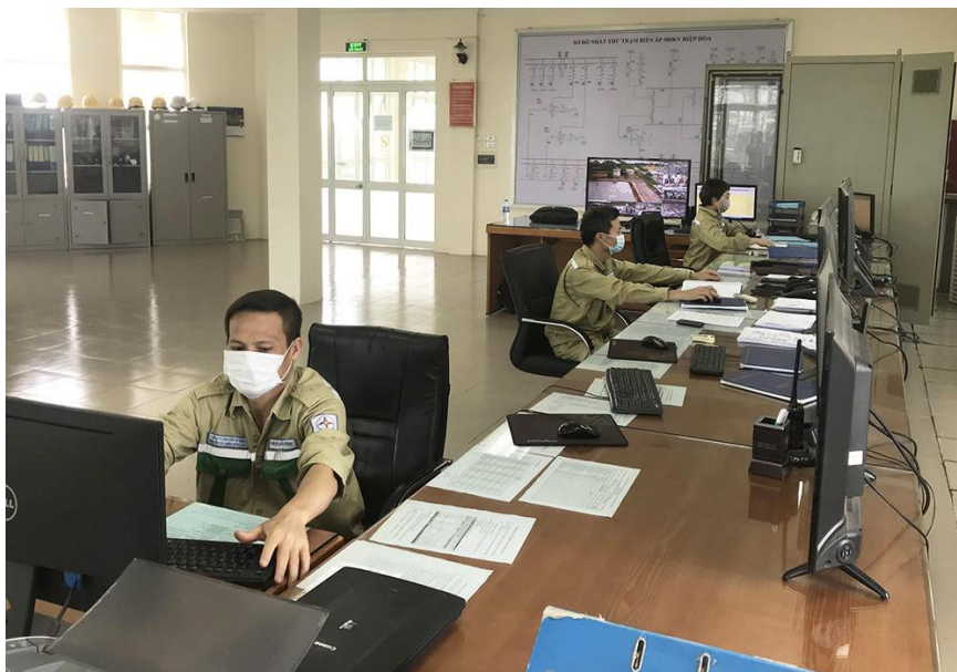
Trực vận hành tập trung tại TBA 500kV Hiệp Hòa (Công ty Truyền tải điện 1).
