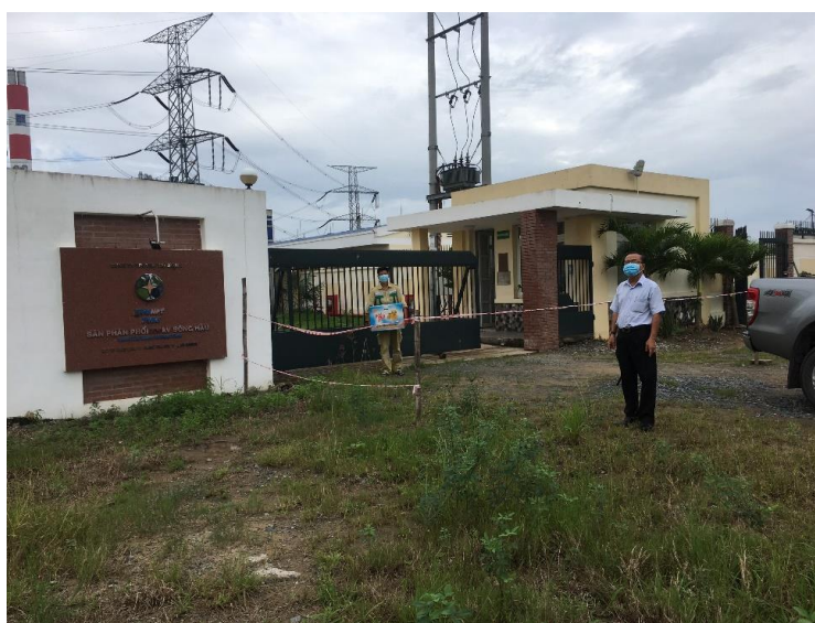
Trạm 500kV Sông Hậu
