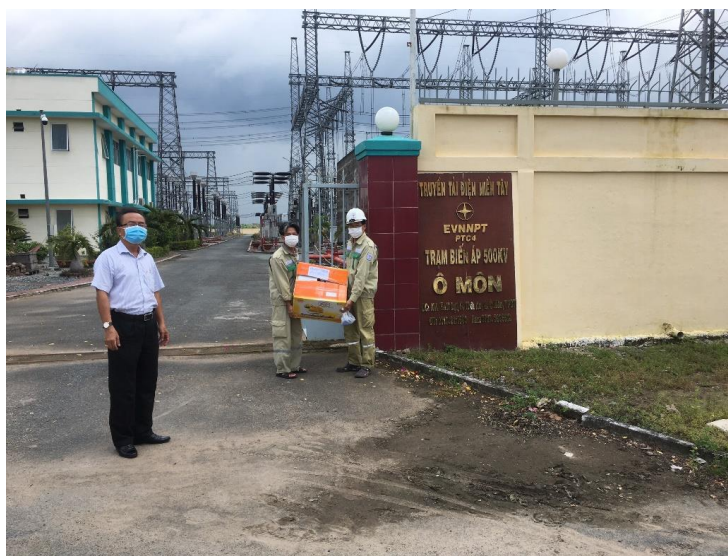
Trạm 500kV Ô Môn
