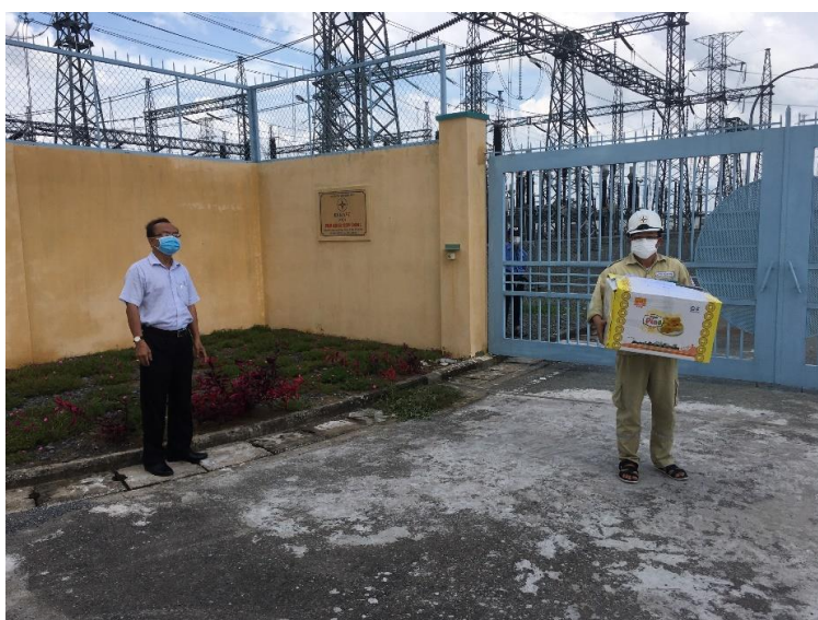
Trạm 220kV Ô Môn 2
