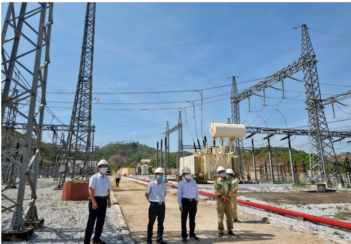
Lãnh đạo PTC2 kiểm tra tình hình thực hiện nhiệm vụ kép và chống dịch vừa đảm bảo cung cấp điện trong mùa nắng nóng tại các trạm biến áp
