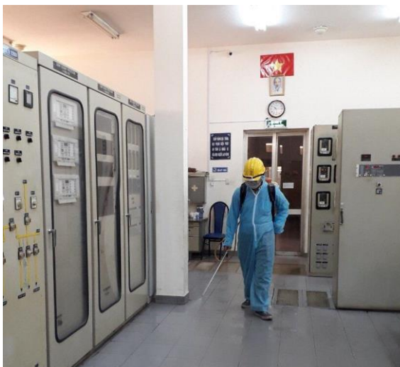
CBCNV Trạm 220kV Nhà Bè thực hiện phun thuốc CloraminB diệt khuẩn khu vực phòng điều hành
