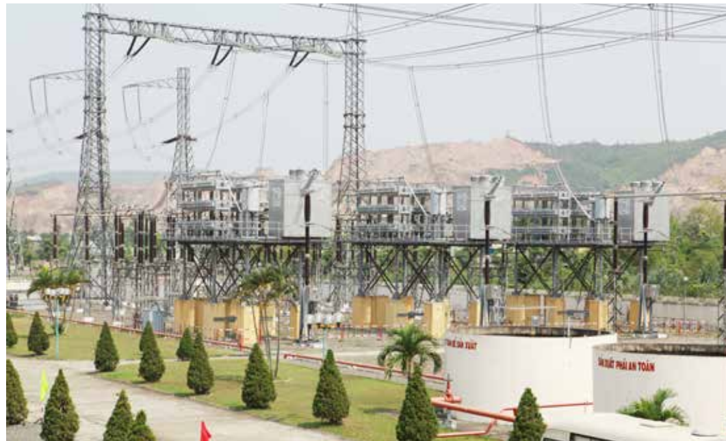
Trạm biếp áp 500kV Đà Nẵng tiếp nhận điện từ đường dây 500kV mạch 1 khu vực miền Trung (ảnh CTV)
