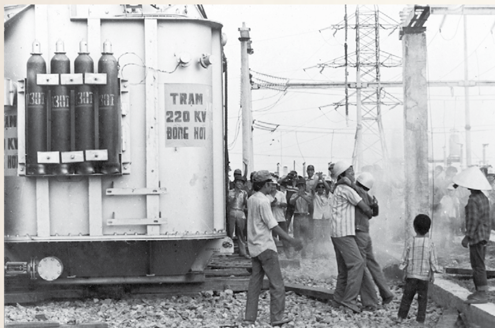
Máy biến áp tại Trạm 220 kV Đồng Hới thuộc Sở truyền tải điện 1 (ảnh tư liệu)
