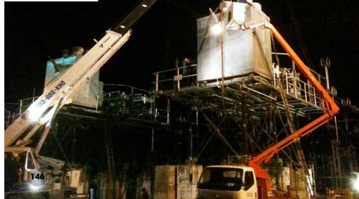
Thi công lắp đặt tụ bù dọc TBA 500kV Pleiku (ảnh CTV)
