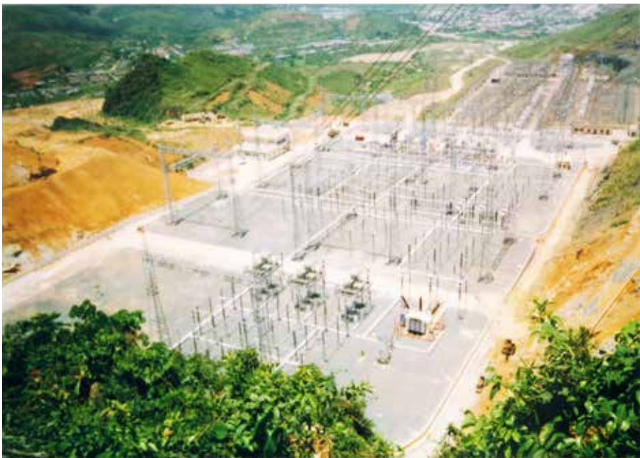
Trạm phân phối - điểm đầu của đường dây 500kV mạch 1 tại NMTĐ Hòa Bình.
