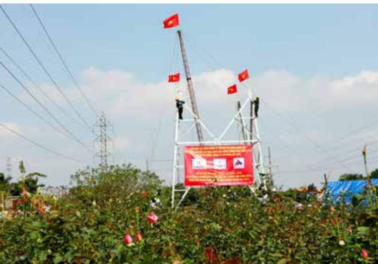
Khí thế thi đua về đích trên công trình đường dây 220kV Vân Trì - Chèm (ảnh Ngọc Hà)
