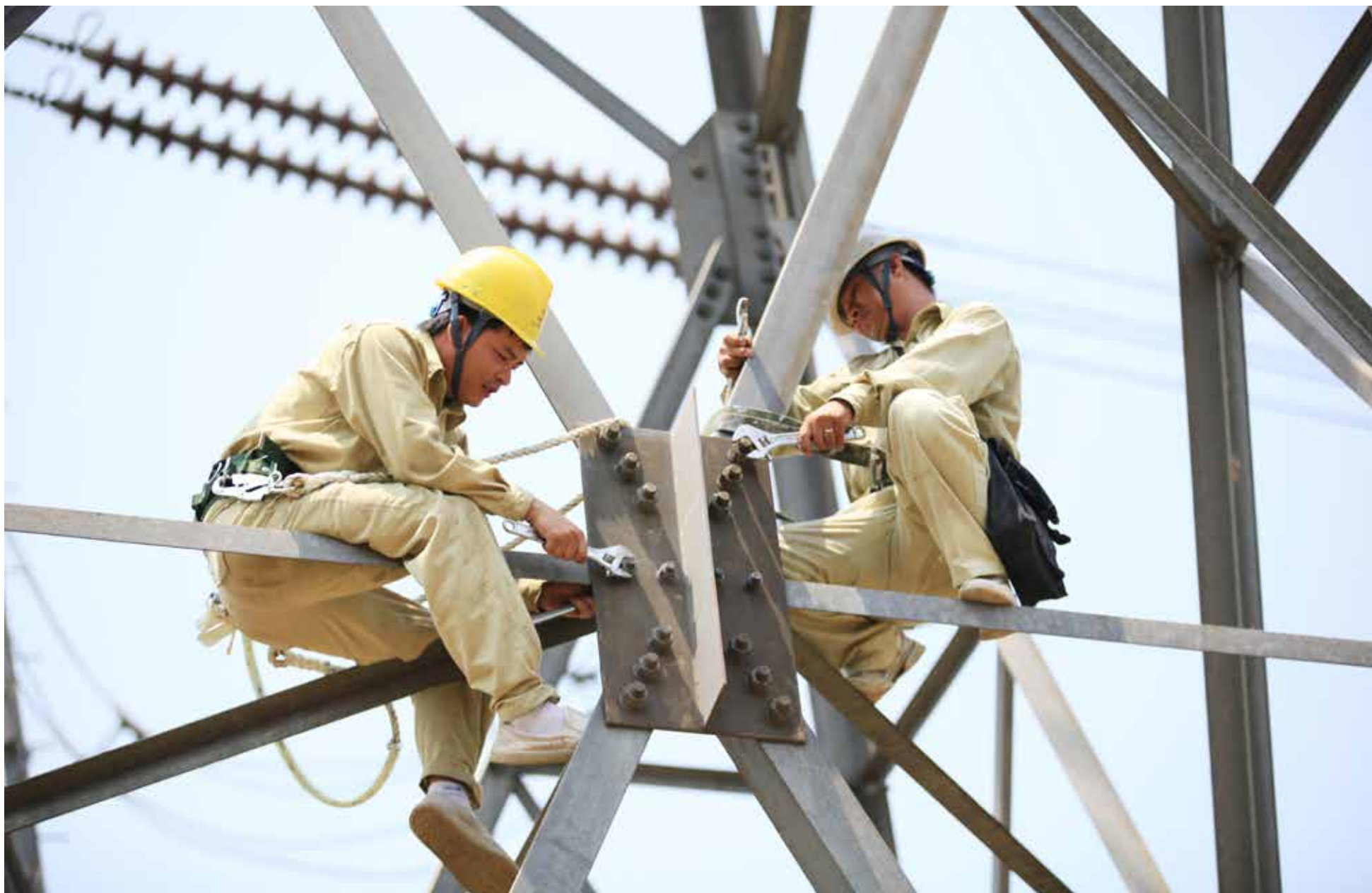
Công nhân Công ty Truyền tải điện 2 bảo dưỡng thiết bị cột và đường dây trên tuyến đường dây 500 KV mạch 1 (ảnh Vũ Lam)
