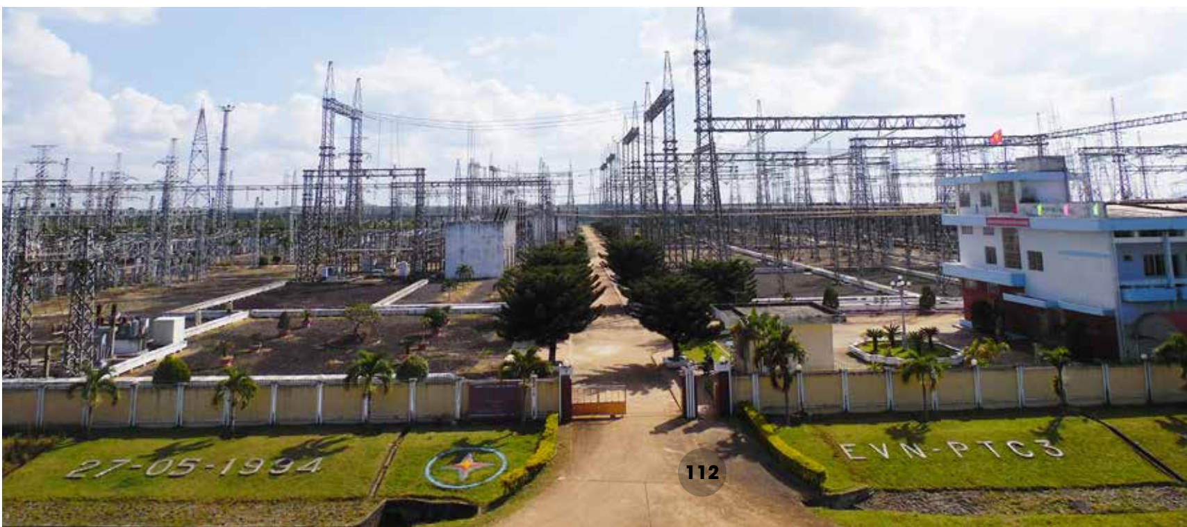
Trạm biếp áp 500kV Pleiku tiếp nhận điện từ đường dây 500kV mạch 1 khu vực Tây Nguyên (ảnh CTV)
