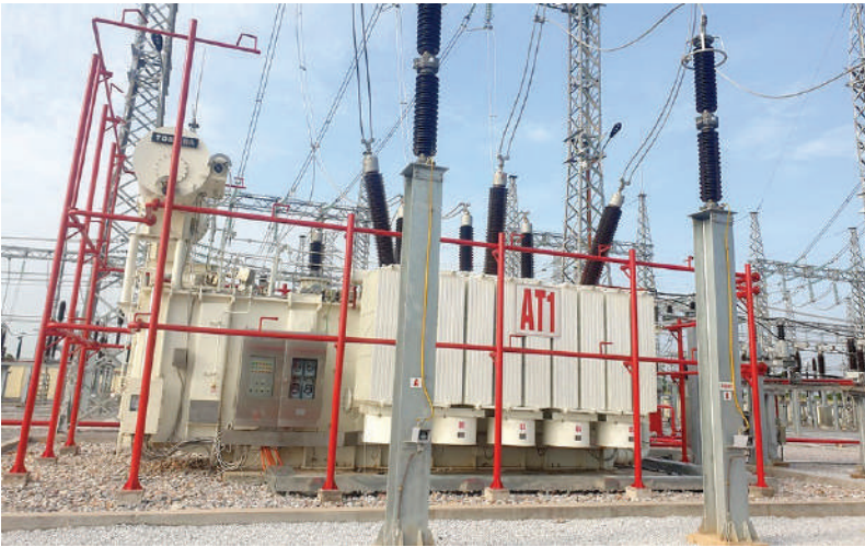
Đóng điện dự án Trạm biến áp 220kV Yên Hưng và đấu nối
