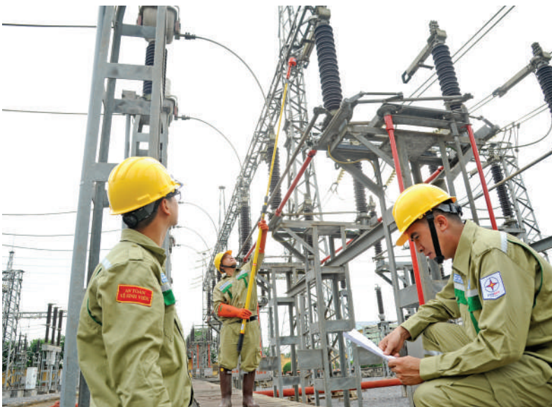
Đội ngũ ATVSV EVNNPT luôn phát huy vai trò hướng dẫn, giám sát, nhắc nhở người lao động sử dụng đầy đủ trang bị an toàn, BHLĐ, thực hiện nghiêm Quy trình ATLĐ
