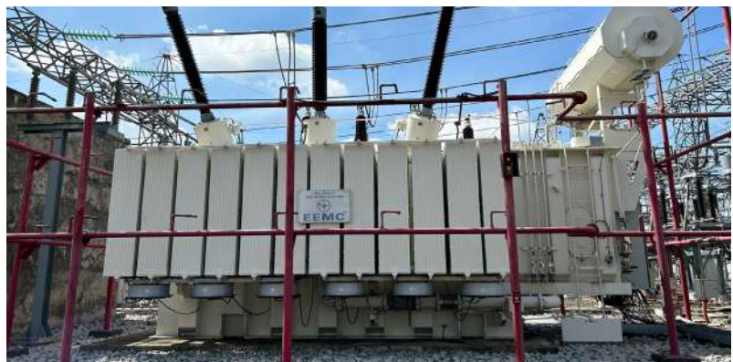
Hoàn tất nghiệm thu đóng điện vận hành MBA 220kV - 250MVA TBA 220kV Trà Nóc
