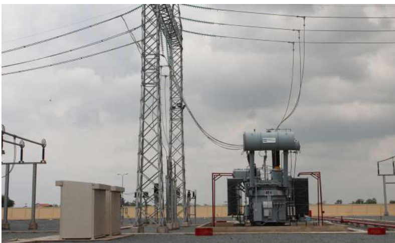
Trạm biến áp 220kV Trà Vinh
