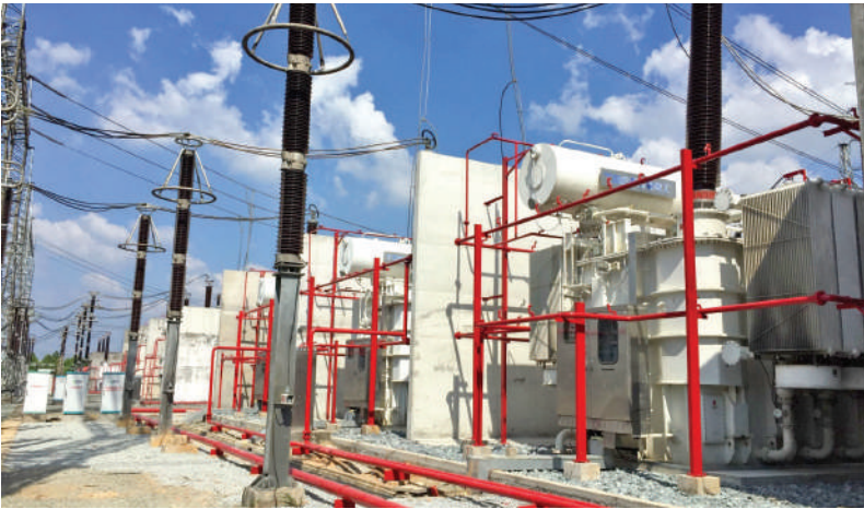
Hoàn thành dự án nâng công suất MBA 500kV 3x300 MVA TBA 500kV Tân Định
