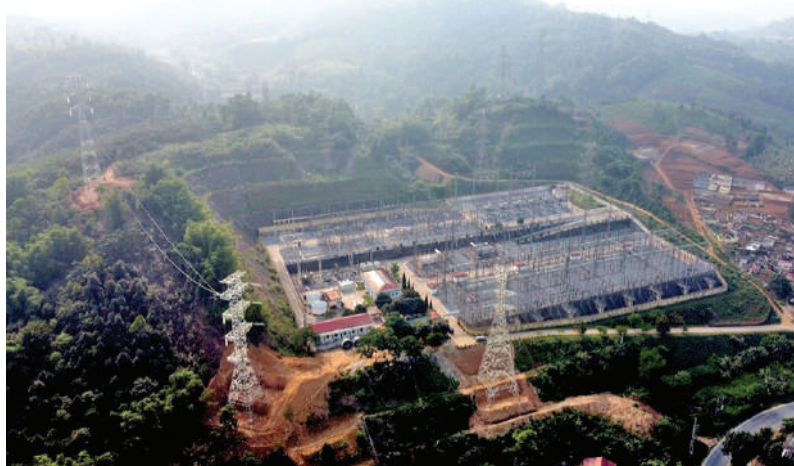
TBA 220kV Lào Cai và đường dây đấu nối
