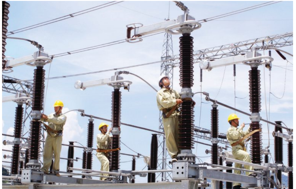
EVNNPT bảo dưỡng, sửa chữa, thay thế thiết bị nhằm ngăn ngừa sự cố và tăng cường độ tin cậy, ổn định của hệ thống truyền tải điện
