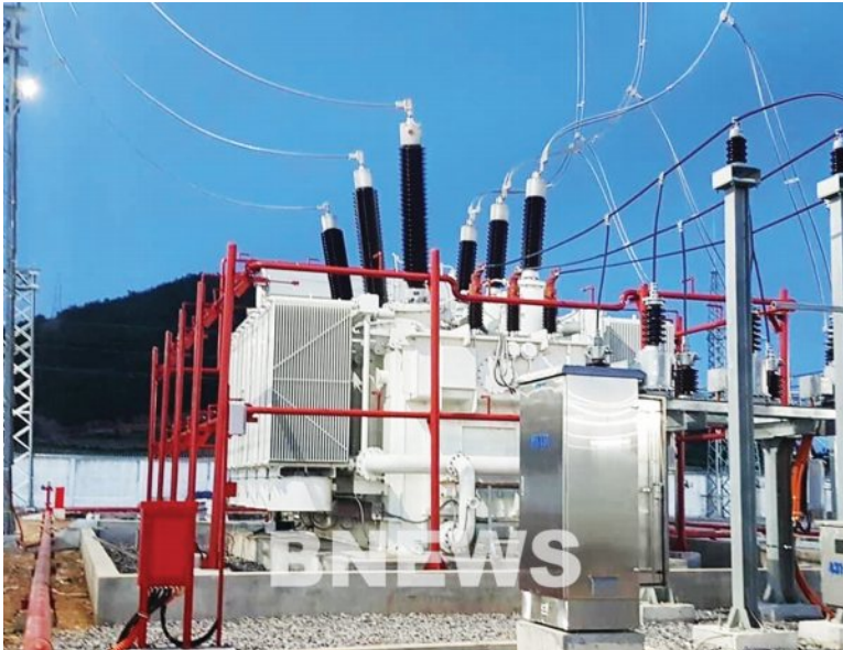
CPMB đã đóng điện máy biến áp AT1 tại TBA 220 kV Văn Phong
