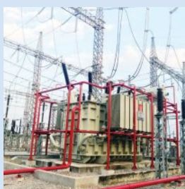
MBA 220/110/22 kV - 250 MVA tại TBA 220 kV Tuyên Quang
