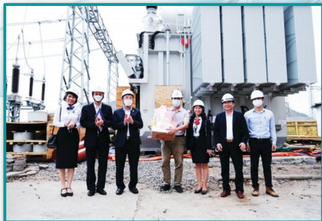
Tổng giám đốc EVNNPT Phạm Lê Phú thăm và tặng quà CBCNV trên công trường thi công thay MBA (AT1 và AT5) bằng MBA 500 kV - 900 MVA Nho Quan - PTC1
