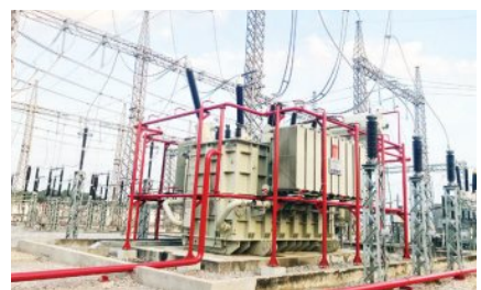
MBA 220/110/22 kV - 250 MVA tại TBA 220 kV Tuyên Quang
