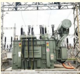
MBA 110/22 kV - 63 MVA tại TBA 220 kV Ngũ Hành Sơn
