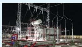
Đóng điện TBA 220 kV Thanh Nghị - Hà Nội
