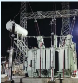
Công trình TBA 220 kV Châu Thành (Hậu Giang)
