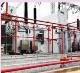
TBA 500 kV Nhà Bè
