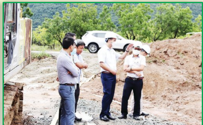
Ông Bùi Văn Kiên - Phó Tổng giám đốc EVNNPT đã kiểm tra tiến độ thi công Dự án ĐZ 500 kV Văn Phong - Vĩnh Tân và TBA 500 kV Văn Phong và đấu nối (ngày 17 - 18/11/2021)
