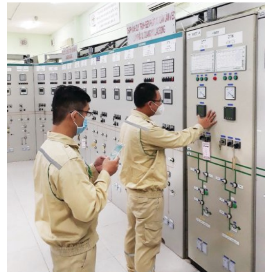
CBCNV Trạm 220 kV Cát Lái thực hiện cập nhật dữ liệu lên chương trình quản lý kỹ thuật trong thời gian thực hiện "3 tại chỗ"
