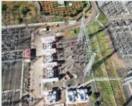
TBA 500 kV Pleiku 2
