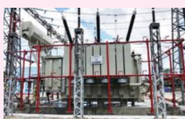
MBA AT2 tại TBA 220 kV Sơn Hà
