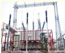
TBA 220 kV nối cấp trong TBA 500 kV Phố Nối
