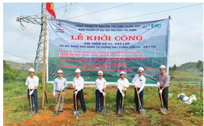
NPTPMB triển khai nâng khả năng tải Đường dây 220kV Sơn La – Việt Trì.
