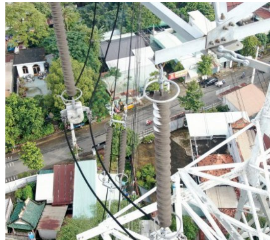
Hình ảnh Flycam kiểm tra thiết bị sau khi sau sự cố sét gây phóng chuỗi sứ lèo composite cột 47 đường dây 220kV Cầu Bông - Bình Tân
