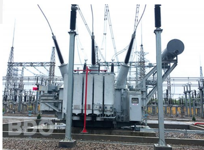
Máy biến áp số 2 có công suất 125 MVA, nâng tổng công suất trạm biến áp 220 kV Phù Mỹ lên 250 MVA
