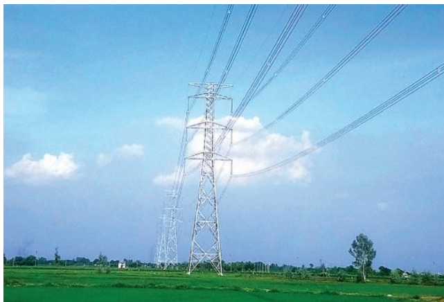
Đường dây 500kV Tây Hà Nội - Thường Tín đã hoàn thành, đóng điện
