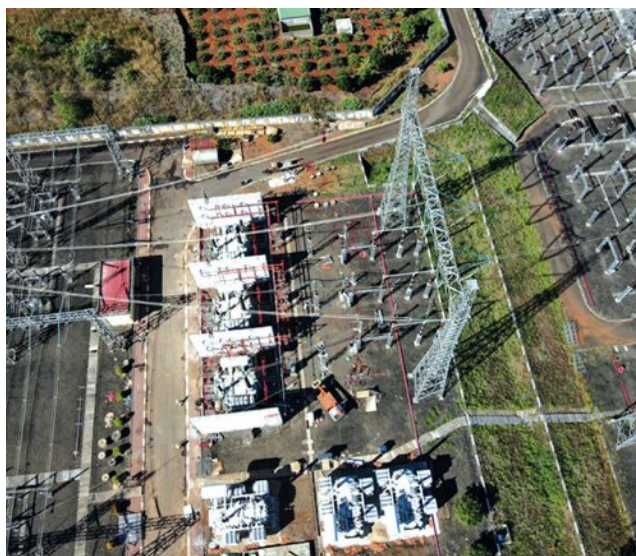
Khu vực lắp đặt máy biến áp 900MVA tại TBA 500kV Pleiku 2
