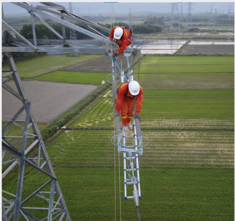
Công ty Truyền tải điện 2 (EVNNPT) ứng dụng thang ra sứ hoàn chỉnh để phục vụ công tác sửa chữa, quản lý vận hành lưới truyền tải điện 220 kV Đây là một trong những sáng kiến được công nhận
