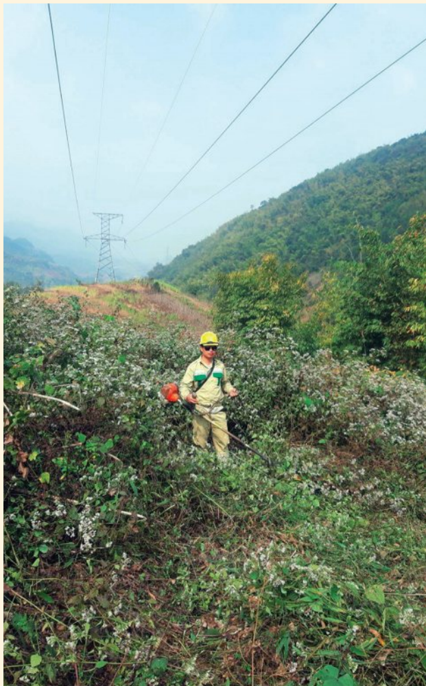
Phát dọn cây chống cháy tại khoảng cột 65 - 66 đường dây 500 kV Sơn La - Hòa Bình - Nho Quan
