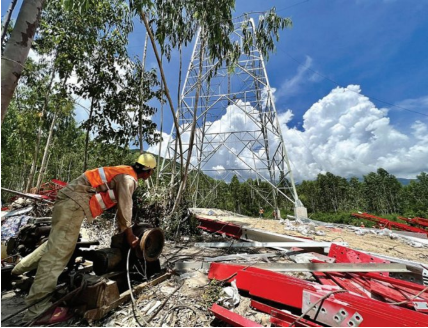
Các nhà thầu đang tập trung thi công dự án đường dây 500 kV Vân Phong - Vĩnh Tân
