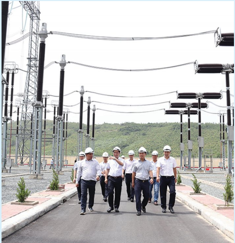
Lãnh đạo EVNNPT kiểm tra kỹ thuật tại Sân phân phối 500 kV Quảng Trạch trước khi đóng điện vào sáng ngày 31/5/2022
