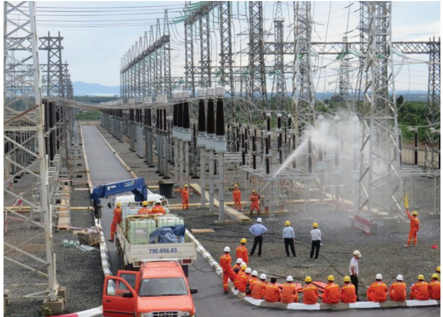
Vệ sinh hotline thực tế tại Trạm biến áp 500 kV Đắk Nông
