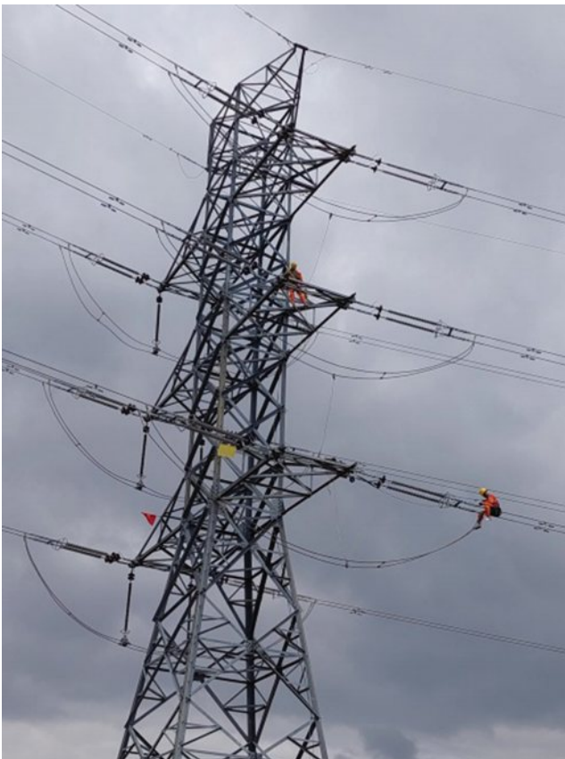
Cờ cảnh báo an toàn làm việc trên các đường dây đi chung cột ban ngày
