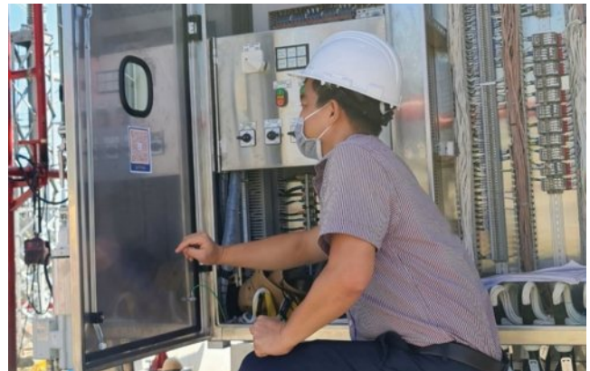
NPTPMB cài đặt ứng dụng mã QR-Code VTTB tại Trạm biến áp 220 kV Huế
