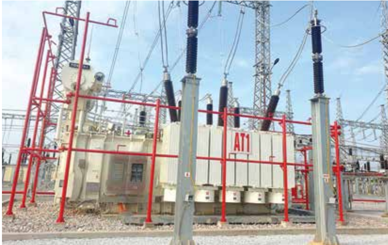
Tháng 6/2022, đóng điện dự án trạm biến áp 220 kV Yên Hưng và đấu nối. Đây là dự án NPTS tham gia thi công và đóng điện, góp phần tăng cường năng lực cấp điện cho hệ thống TĐ trong khu vực.
