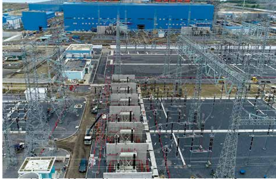
gov.vn và Báo Đấu thầu theo đúng Tập đoàn có văn bản hướng dẫn Trạm biến áp 500kV Vân Phong đóng điện ngày 28/11/2022, vượt tiến độ 27 ngày so với kế hoạch, sẵn sàng phục vụ Nhà máy Nhiệt điện BOT Vân Phong 1 phát điện thử nghiệm
