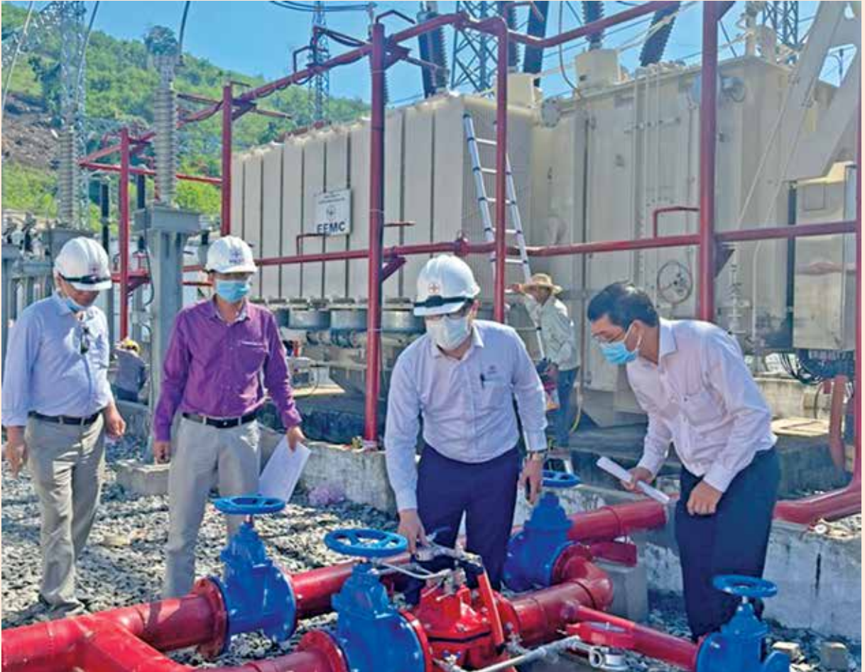
Lãnh đạo NPTPMB kiểm tra nghiệm thu hệ thống PCCC tại dự án nâng công suất Trạm biến áp 220 kV Sơn Hà
