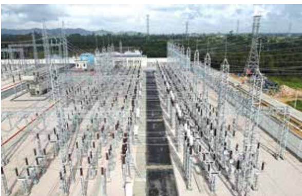
Trạm biến áp 220kV Duy Xuyên và đường dây đấu nối
