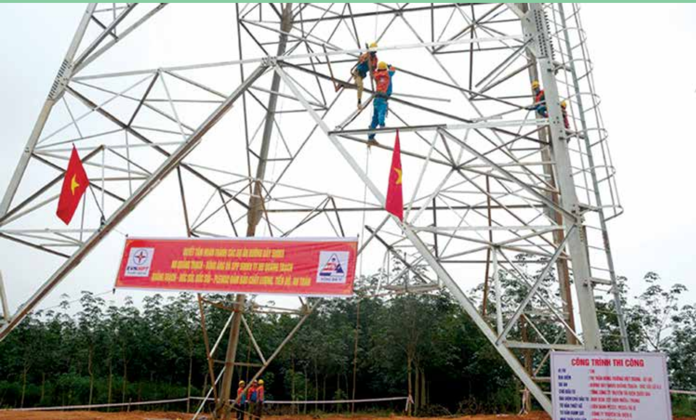
Thi công ĐZ 500kV mạch 3 tại vị trí cột 158 (thị trấn Nông trường Việt Trung, huyện Bố Trạch, tỉnh Quảng Bình)
