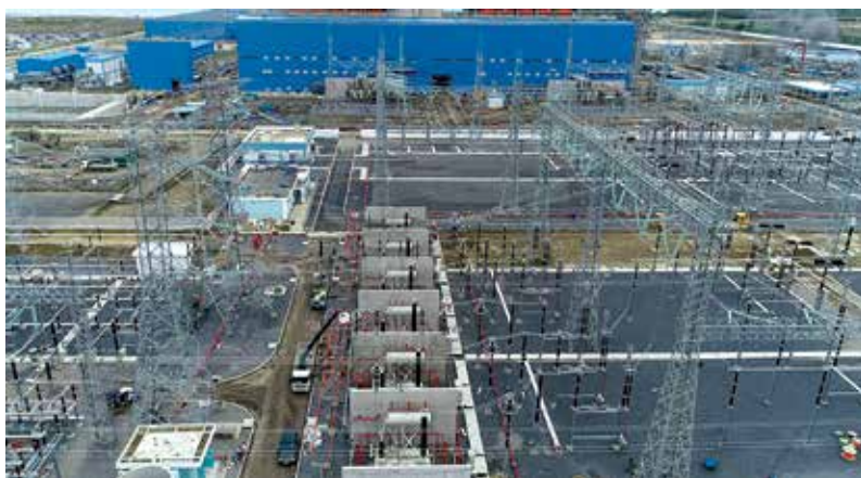
Năm 2022, CPMB đã phối hợp với các đơn vị liên quan đóng điện Dự án Trạm biến áp 500kV Vân Phong và đấu nối, vượt tiến độ 27 ngày so với kế hoạch
