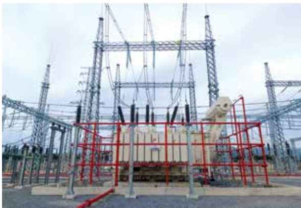
Trạm biến áp 220kV Cam Ranh hoàn thành, đóng điện
