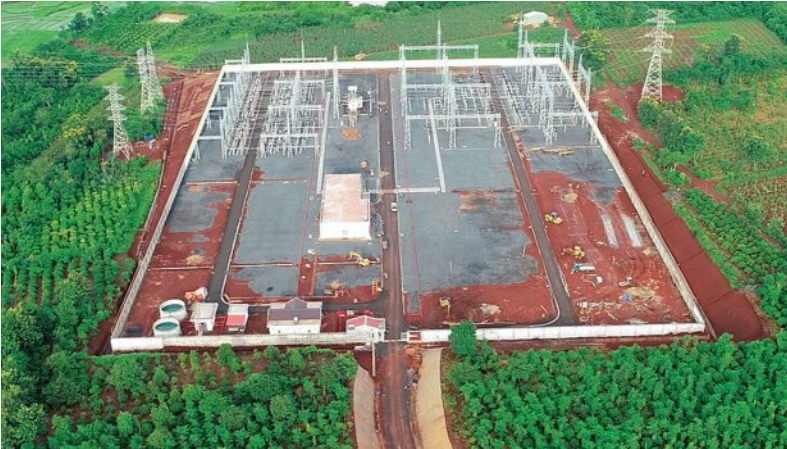
Trạm biến áp 220 kV Chư Sê và đấu nối
