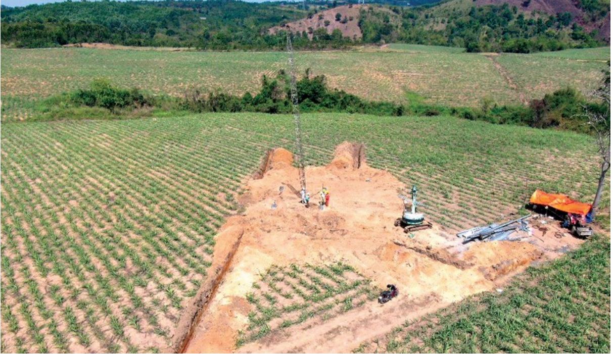
Hình ảnh sử dụng UAV chụp ảnh thi công tiếp địa từ trên cao
