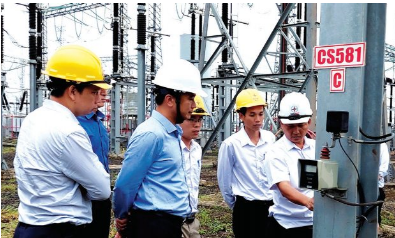
Nghiệm thu Nhiệm vụ KHCN “Giám sát vận hành các thiết bị nhất thứ trong Trạm biến áp” tại Trạm biến áp 500 kV Pleiku 2
